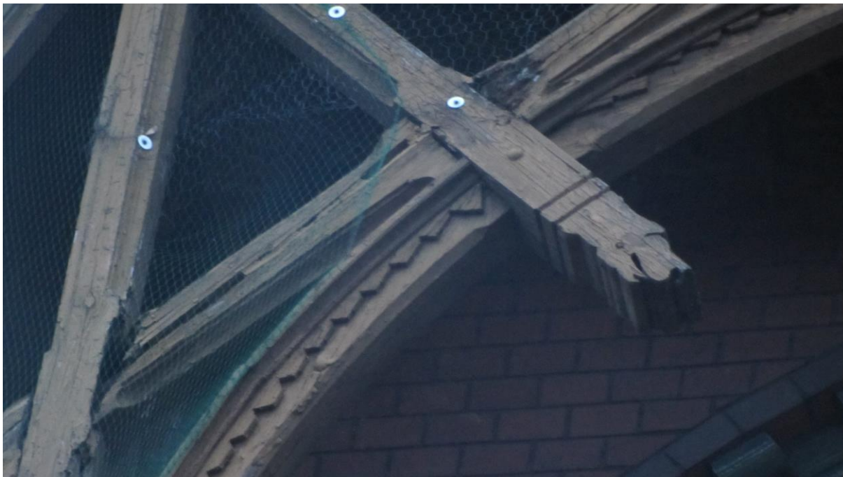
Fot 5. Zmurszałe części konstrukcyjne wymagające pilnej interwencji fasada z kołem sterowym okrętu. Mateusz Stankiewicz 2024.
